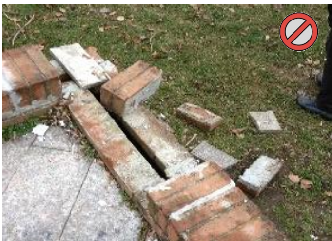
I MURETTI DEGRADATI
